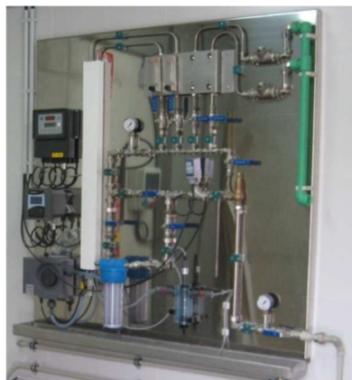
Foto 8A: Panel de control (E.V.A.) de calidad en terciario Sistema Culebro.
