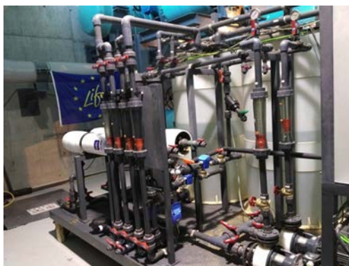
Figura 1. Planta piloto para la validación de membranas recicladas de UF para el pretratamiento de agua de mar
