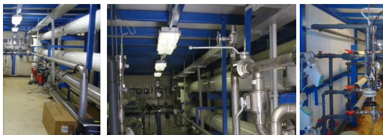
Figura 6.- Vista del Filtro de cartuchos, Primer y Segundo Paso de O.I
