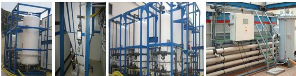
Figura 4.- Floculadores hidráulicos, Decantador Lamelar, Filtros Duales y Floculador hidráulico en tubería y FAD.
