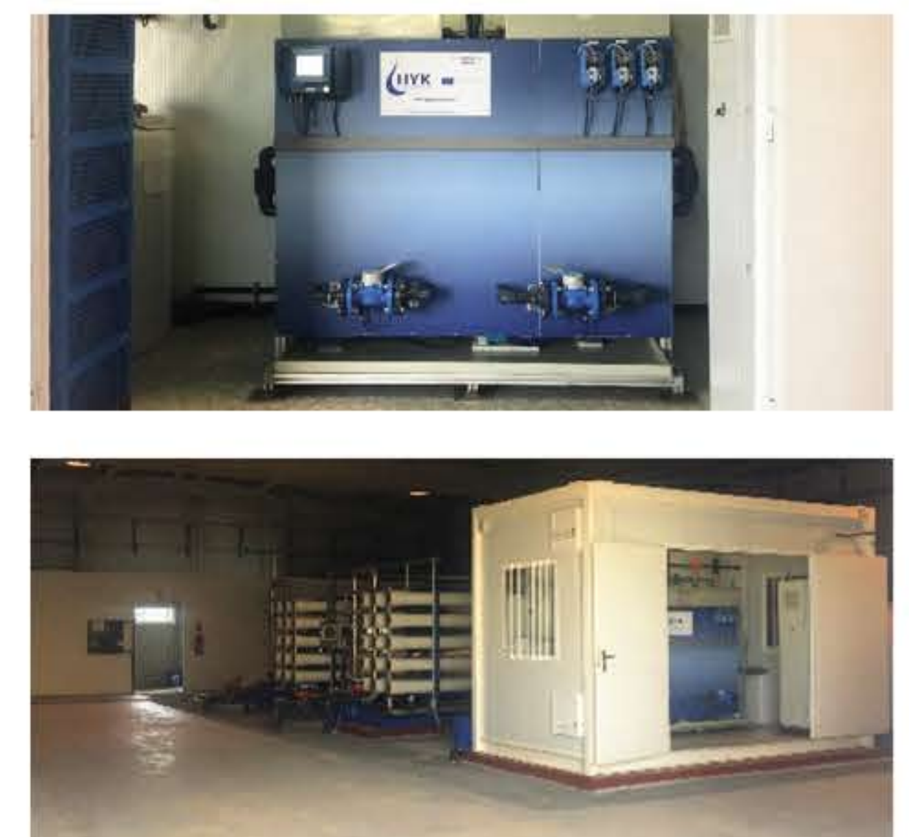
Figura 3. Detalles de la planta piloto instalada en la potabilizadora de Burriana.
